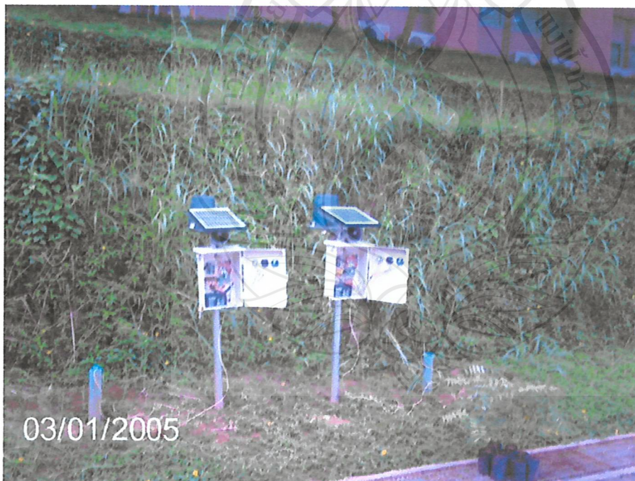
ภาพที่ 4-20 อุปกรณ์ตรวจจับสภาพ และเตือนภัยดินถล่ม
