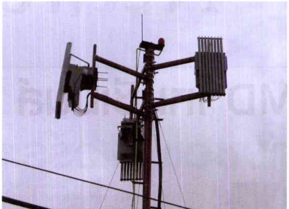
รูปที่ 5 Base Station Antenna ที่ชุมสายร่องปลาแก้ว อ.เมือง เชียงราย
