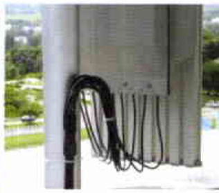
รูปที่ 2 Base Station Antenna ที่มหาวิทยาลัยแม่ฟ้าหลวง
