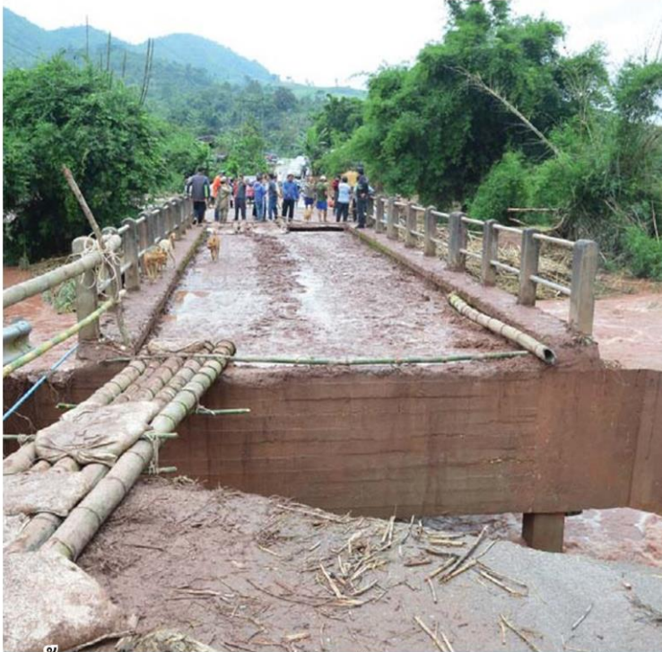
■ น้ำป่า ■ อิทธิพลของพายุโซนร้อน "เตี้ยนหมู่" ทำให้เกิดฝนตกหนักน้ำป่าไหลทะลักและดินโคลนถล่มสะพานบ้านกวน้ำ หมู่ 9 ที่เชื่อม ต.หนองแดงและ ต.น้ำพาง อ.แม่จริม จ.น่าน จนคอสะพานขาด เจ้าหน้าที่ต้องนำอุปกรณ์สะพานเบร้งมาติดตั้งเพื่อบรรเทาความเดือดร้อน เมื่อวันที่ 20 ส.ค.
